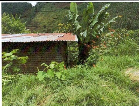
Foto 4: Mejoramiento de Puerta - la puerta actual no esta en buenas condiciones
